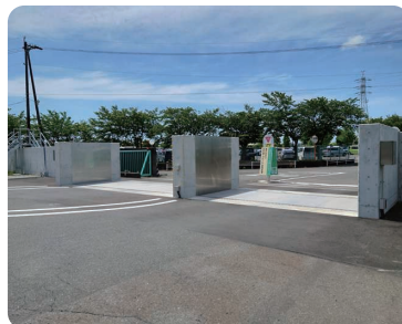
浸水すると自動で閉じるゲートの設置
